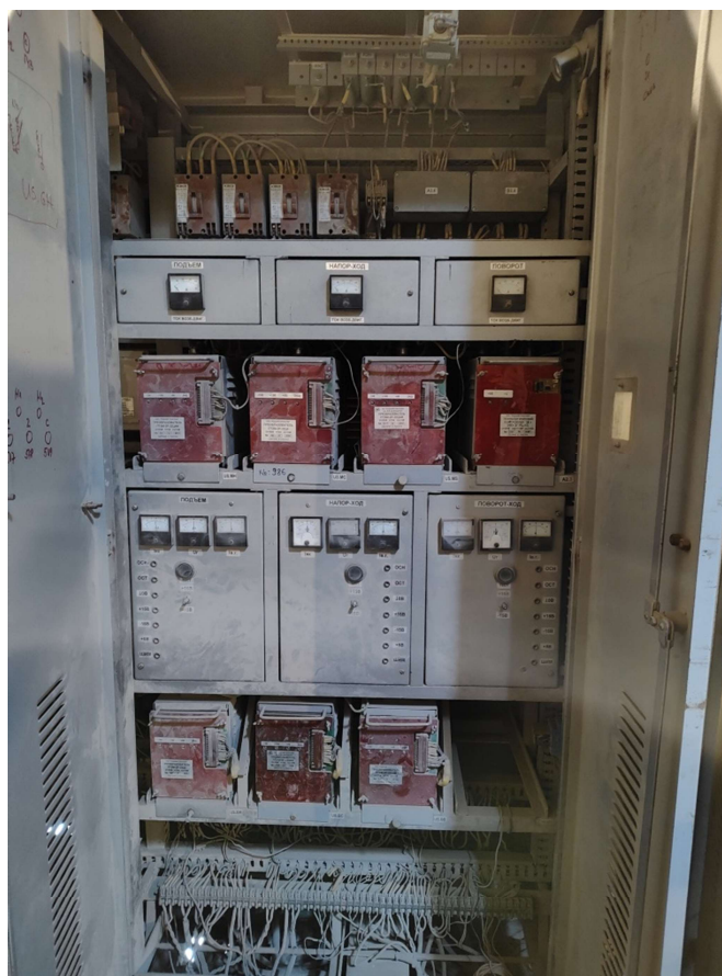
Slika 2.2.1. Ormar za upravljanje glavnim pogonima.
